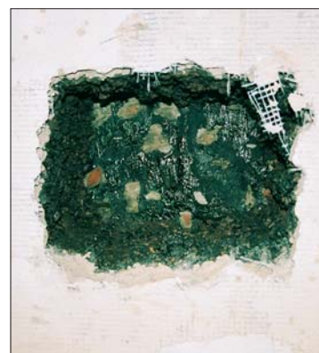
... oder der PAK-haltigen Backkorkisolierung der mehrfach übermalten Wandbeschichtung.
