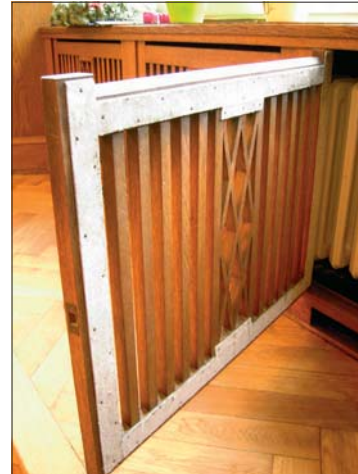
Schadstoffe tauchen vor allem in alter Bau-substanz auf, beispielsweise bei dieser asbesthaltigen Pappe hinter der Heizverkleidung ...
